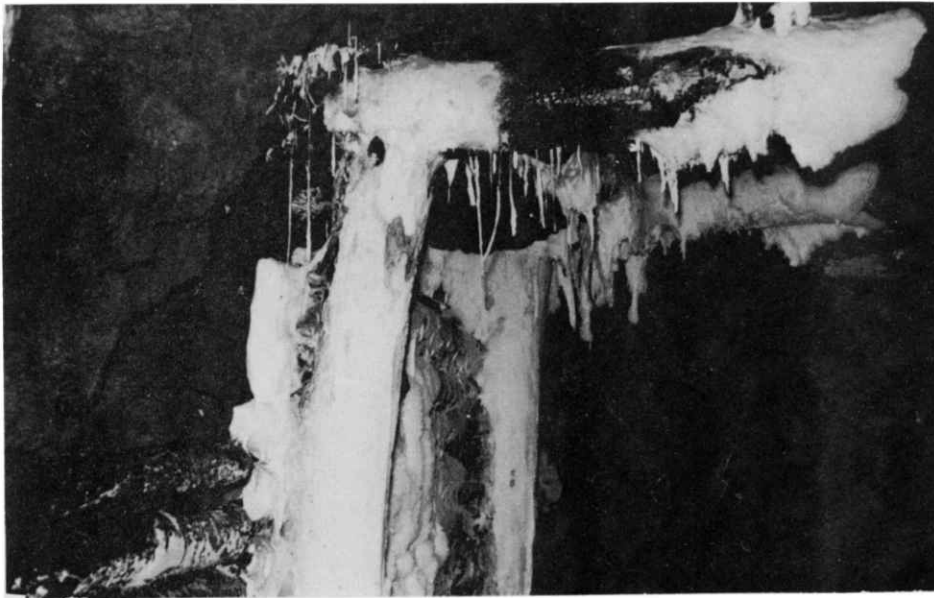
坑口から400 m付近の坑木に発生しているカビ。色は白またはごくうすい黄色で、綿アメといった感じである。
