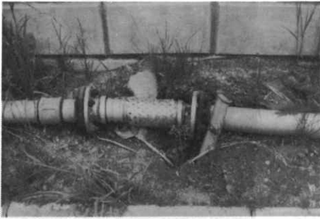
写真5 地盤変動により水道管を護るため写真のようなフレキシブルなジョイントが使用されている
