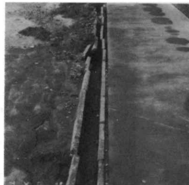
写真2 地盤の圧縮変動により押しつぶされたU字溝
