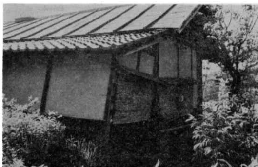
写真—1 飯森山 ⑭ 陥没による家屋の被害 Damaged houses by vibration.
