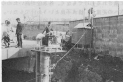
写真1 触針水位計ヘッド庭窪観測所
