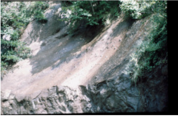
柳久保池 善光寺地震被害
