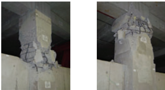
(1) 1 層 X_1Y_2 短柱(加振 5 後) (2) 1 層 X_1Y_3 短柱(加振 5 後)
