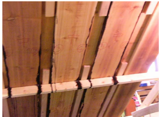
図 20 屋根裏の漏水状況
