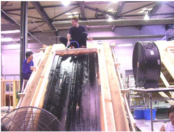
図 19 防水性能実験装置
