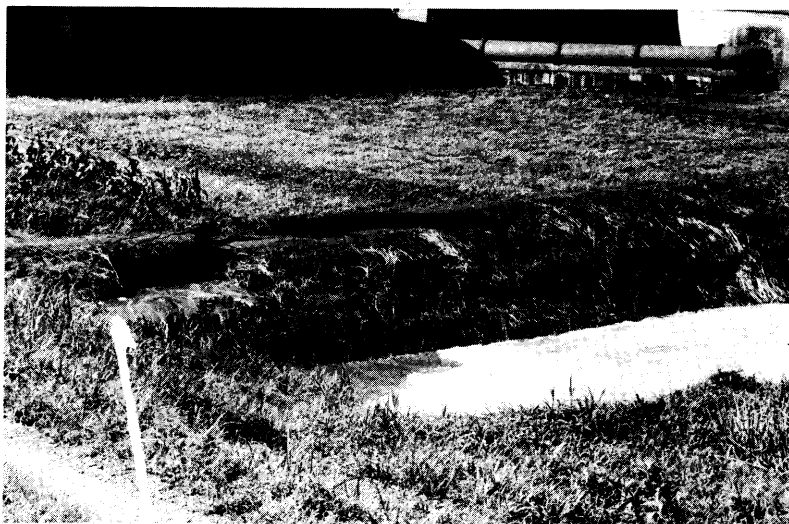
写真4.12 堤内地法尻からの漏水（右側の水面は，小貝川への排水路 写真4.12～写真4.19は，いずれも写真4.11と同一地点で， 石下町役場提供）
