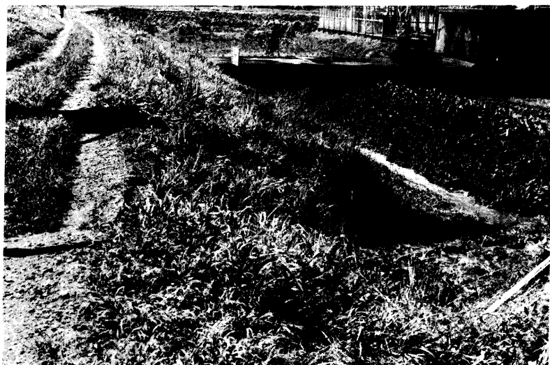
写真4.15 堤防に2条の亀裂がはいる
