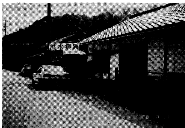
写真 3.8 下府町の住家の洪水痕跡, 浸水深は道路の上 2.26 mにも達した。1988.8.17 撮影
