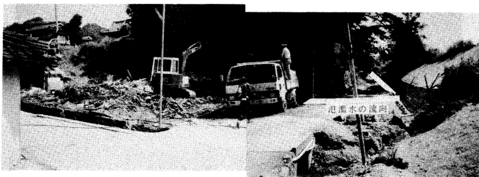
写真 3.17 氾濫水が狭いところを蛇行して流れ、広くなった出口の所で流速を増し、住家を破壊した （JR下府駅東側），1988.8.17 撮影
