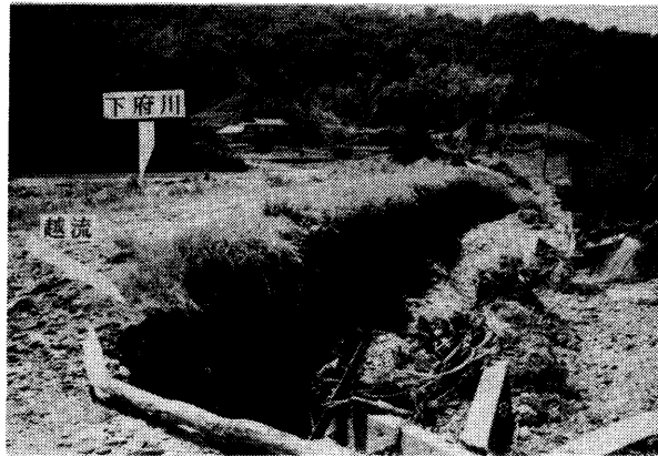
写真 3.15 下府川堤防を洪水が越流し、堤防の裏のりを洗掘した（上府町三重地区）。 1988.8.17 撮影
