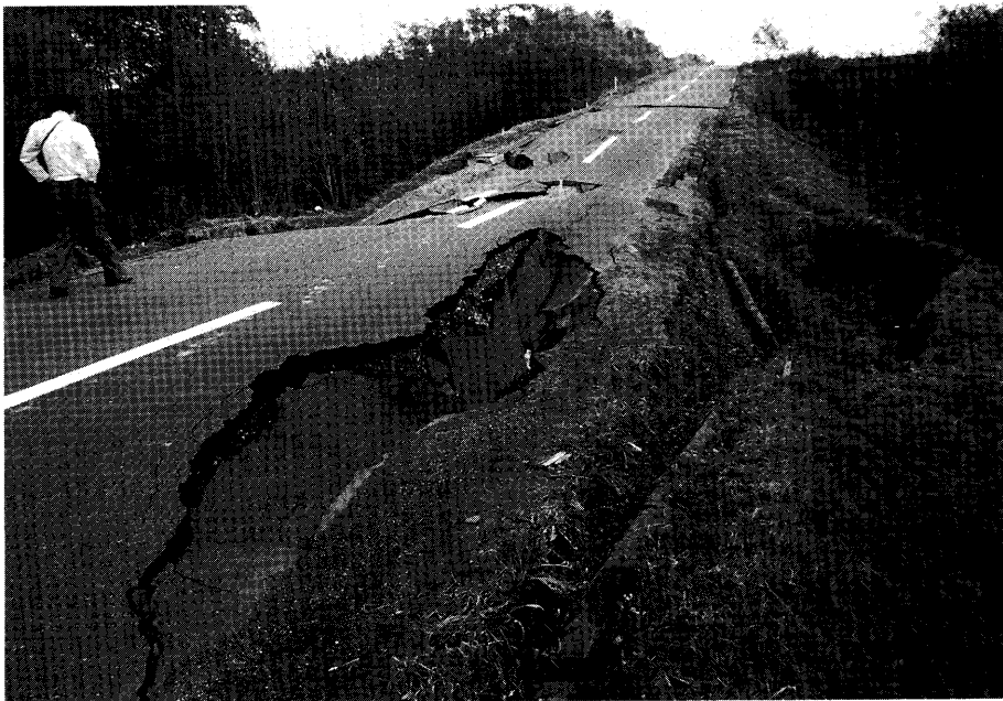
写真9 中標津町郊外道路被害 Photo 9 Road Damage in Nakashibetsu Suburb
