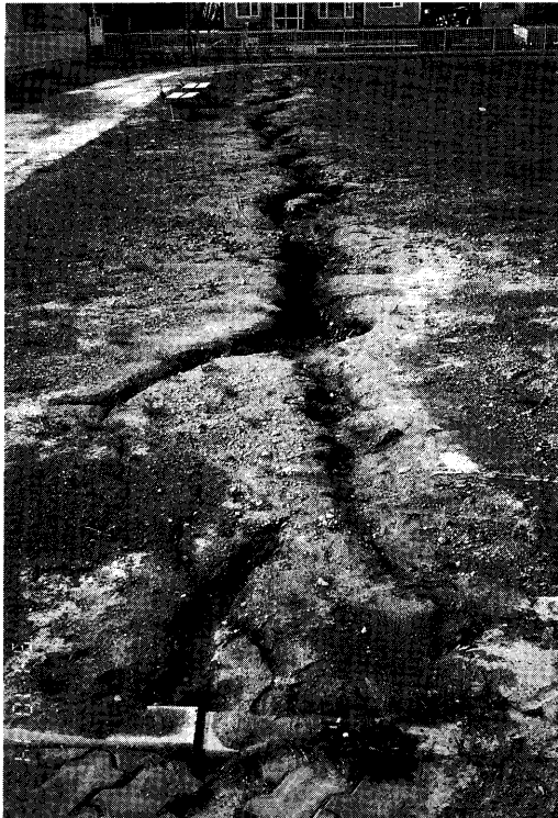
写真21 尾岱沼港公園の地割れ Photo 21 Ground Fissures (Play Ground, Odaito Port Property)
