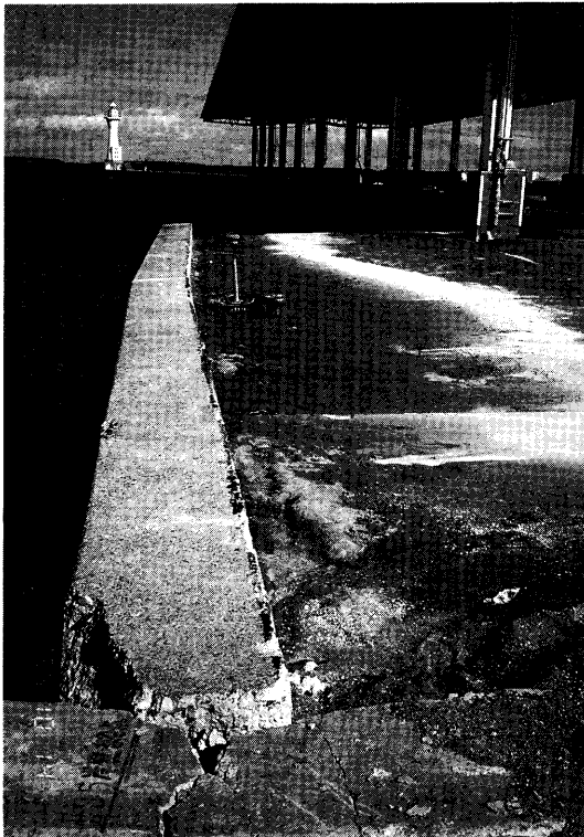
写真20 尾岱沼港南埠頭の岸壁の変形 Photo 20 Tilting of Quay Walls (South Pier, Odaito Port)
