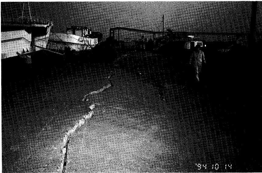
写真19 花咲港西地区の亀裂と沈下
