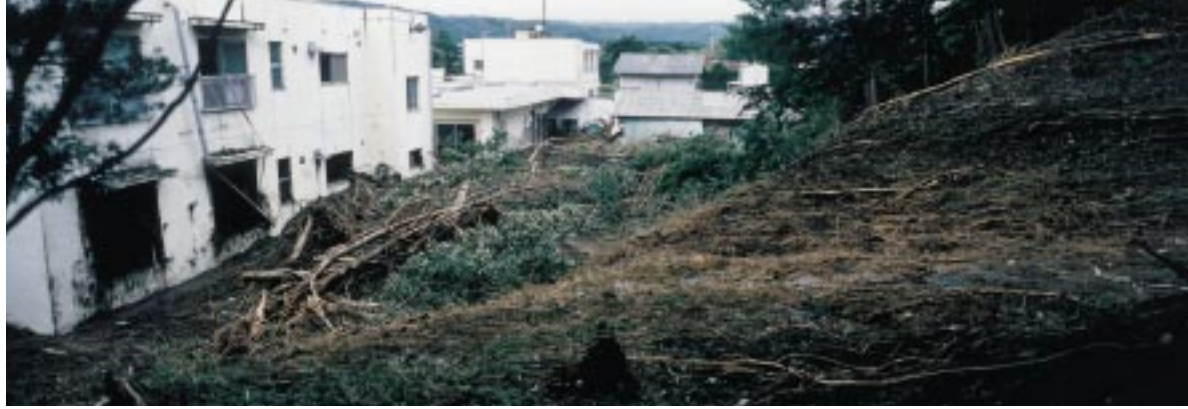
写真1 西郷村「太陽の国」のからまつ荘の土砂崩れによる被災状況，ここで5名の方が亡くなった。 Photo 1 The buried Karamatsu Home in “Taiyo-no-kuni”, Nishigou Town caused by the slope failure, where fatalities numbered 5.
