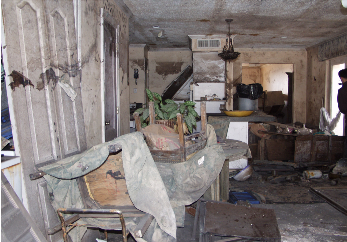
写真 5 17th Street Canal の破堤地点付近の家屋 (2005 年 12 月 4 日撮影) Photo 5 Damaged house near the levee breach point on 17th Street Canal.
