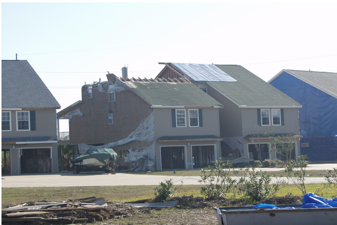
写真 7 風災害の様子:ブルーシートで覆われた屋根 風災害の様子 (2005 年 12 月 2 日撮影) Photo 7 Damaged roofs covered by blue sheets.
