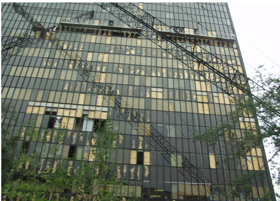
写真 8 風水害の様子:高層ビルの窓ガラス (2005 年 12 月 2 日撮影) Photo 8 Damaged office tower windows.
