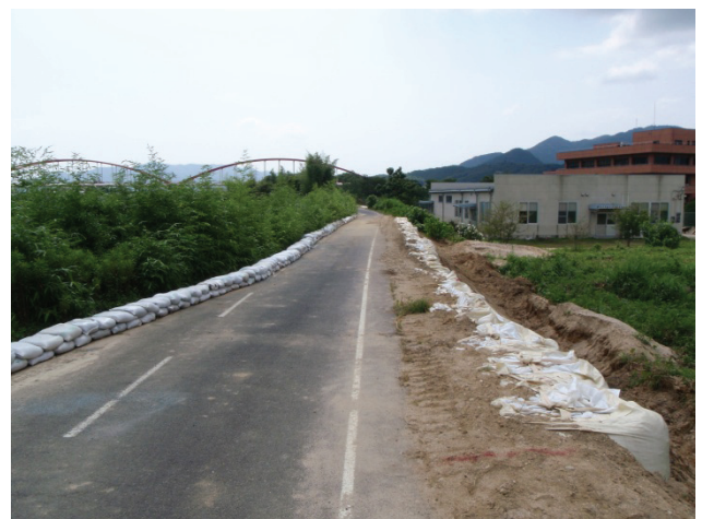
図11 朝田浄水場付近堤防の損害状況
