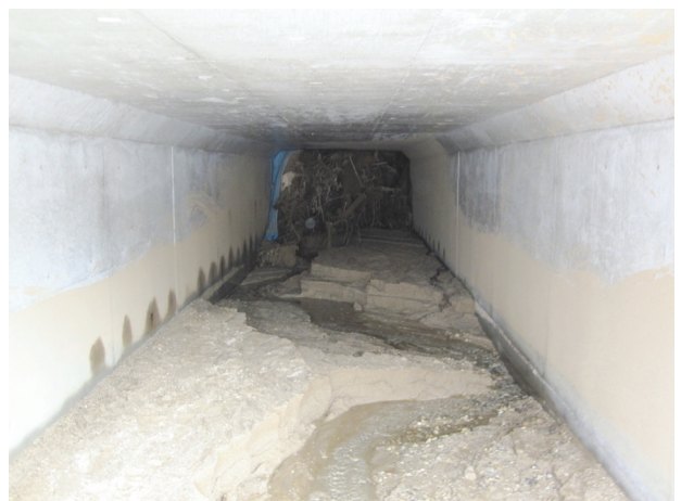
写真9 擁壁に設けられた水路用のトンネル。内部は堆積した土砂と流木で埋まっている。 Photo 9 Tunnel filled with drift woods and sand.
