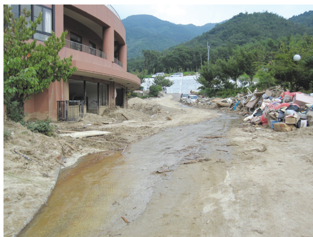
写真2 ライフケア高砂（本館建物）の北側面。画面奥の施設裏手から土石流が流下した。
