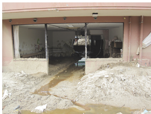
写真3 土砂が流入した老人ホーム本館居室の窓
