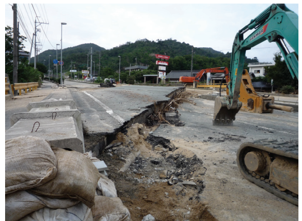
写真3 勝坂の被害状況(筆者撮影)
