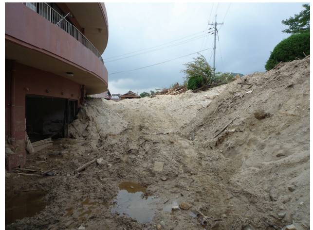
写真7 南郷の老人ホームの被災現場(筆者撮影)
