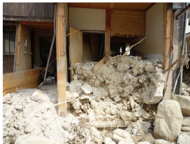
写真 6 下郷の被害状況(筆者撮影) Photo 6 The damage situation of Shimogou.
