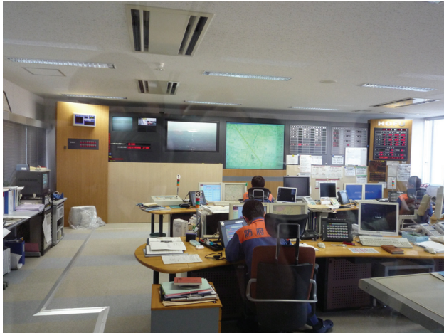
写真 1 防府市消防本部通信指令室(筆者撮影) Photo 1 Command And Control Center of Hofu City Fire Department.
