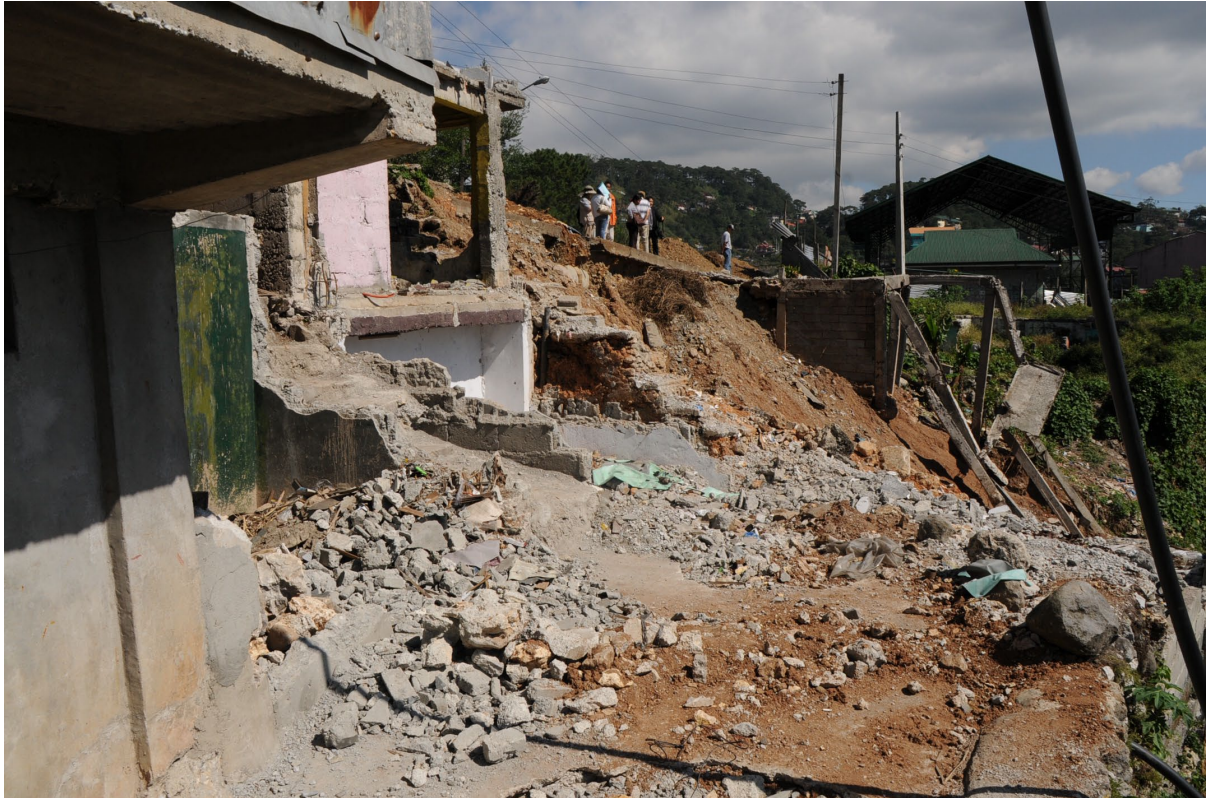
口絵 1 バギオ市内の道路脇で起きた土砂崩れ（撮影：井口 隆）
