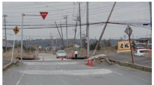
写真1 歩道下の水路の浮き上がり、電柱の傾斜(神栖市平泉) Photo 1 The rise of waterway under side walk and slant of telephone poles (Hiraizumi, Kamisu).
