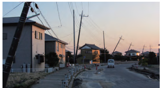
写真7 道路に広がる噴砂と電柱の傾斜。まっすぐ立つ電柱は復旧のために新たに建てた電柱(潮来市日の出)
