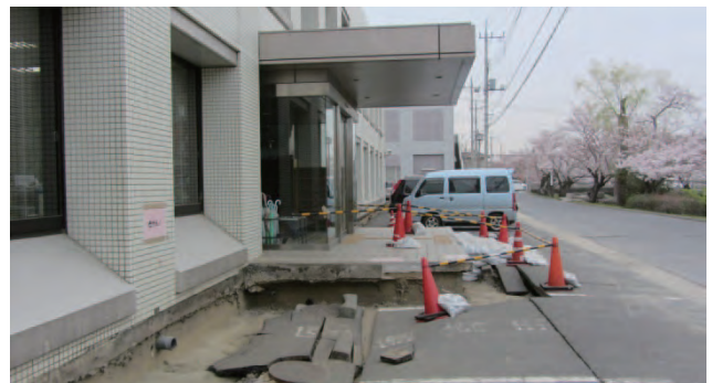
写真8 香取市保健センター前の地盤沈下(香取市佐原) Photo 8 Subsidence in front of katori health center (Sawara, Katori).
