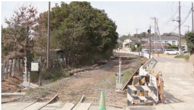
写真3 盛土の滑動による軌道の湾曲(鹿嶋市鉢形) Photo 3 A track curves by sliding of the embankment (Hachigata, Kashima).
