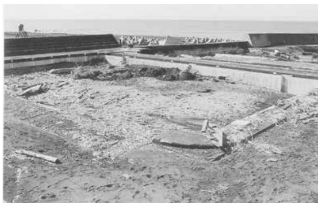
図 10 1979 年台風 20 号により砂に埋まった元町プール (場所：元町，出典：大島町町制施行 50 周年記念 事業実行委員会，2006)
