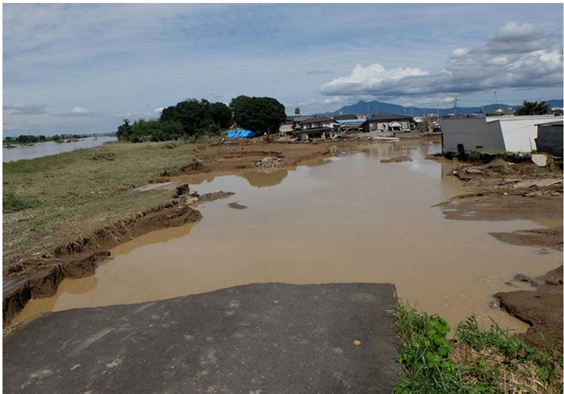
口絵 3 決壊から 24 時間後の鬼怒川堤防決壊地点 (撮影: 2015 年 9 月 11 日 12:25, 茨城県常総市三坂町, 上三坂地区)
