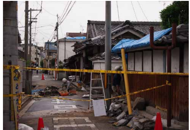
図 5 茨木市宮元町の被災状況(撮影日 6/22) Fig. 5 Damage situation of Miyamotocho, Ibaraki City (shooting date 6/22).
