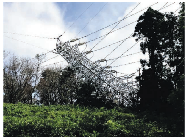
図 1 千葉県内における鉄塔の倒壊
