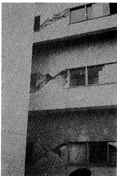
No. 48 三沢市昭陽小学校 (青森県三沢市) 開口部と壁体の間に生じる亀裂 の状況
