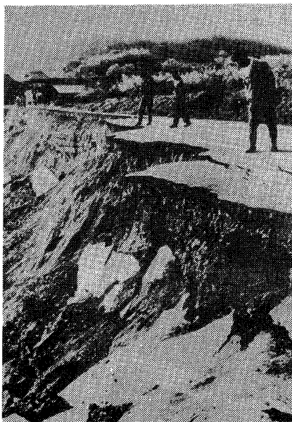
No. 9 青森市三戸町 道路の崩壊、センターライン から半分が崩れる。 (共同通信社 提供)
