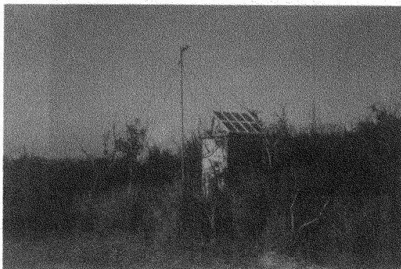
写真2. 送信用アンテナと局舎。局舎の屋根に設置された太陽電池により送信機，増幅器を作動させている。送信は400 MHz帯で空中線電力は0.1 W。（硫黄島火山活動第1観測施設）
