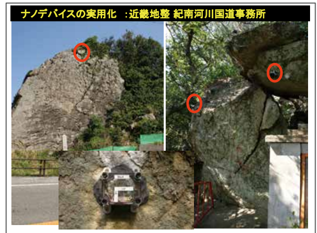
図 12 岩盤斜面上の岩石ブロック挙動監視用に取り付けられた MEMS 傾斜計センサー
