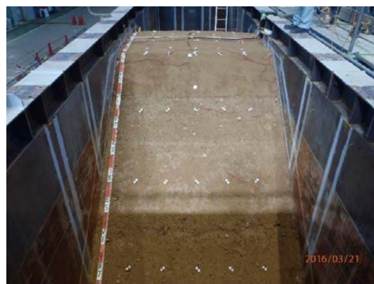
写真 25 シート側上流法面クラック発生状況 Photo 25 Distribution of cracks on the slope surface of downstream in the case of GCL.
