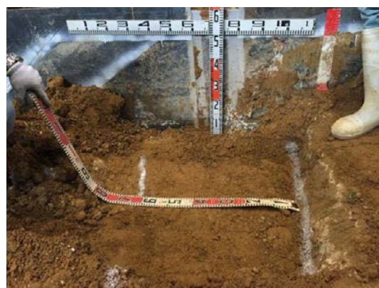
写真 19 発生クラックの掘削調査状況 18)
