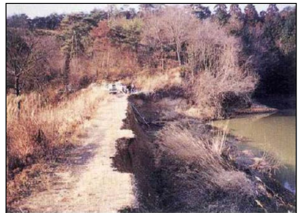
写真 1 二六池の被災状況
