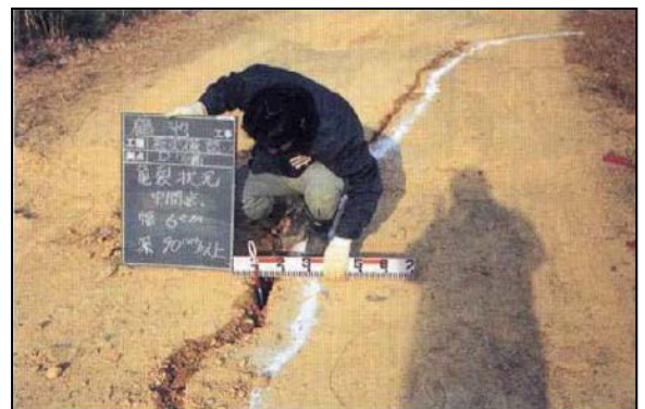
写真 3 鶴池の被災状況
