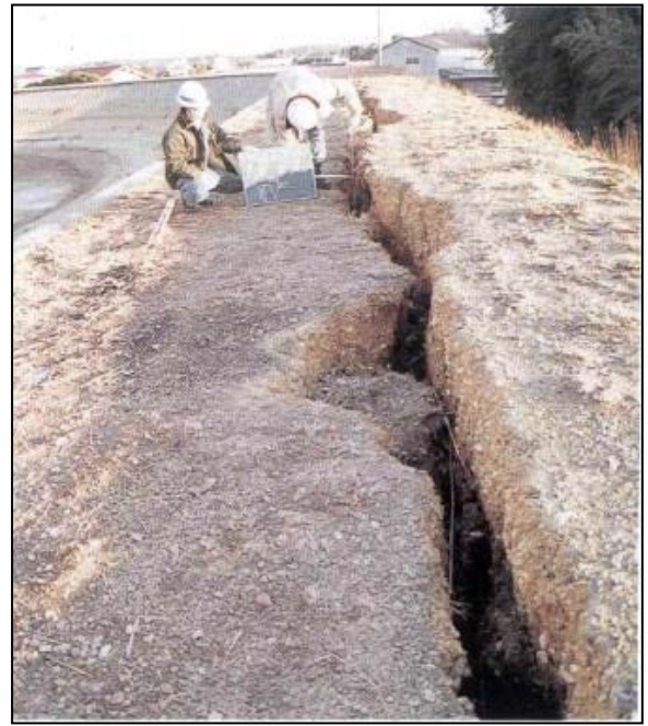
写真 2 小鳥喰池の被災状況
