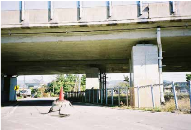
写真3 小千谷市内のマンホールの浮き上がり(2004年新潟県中越地震)
