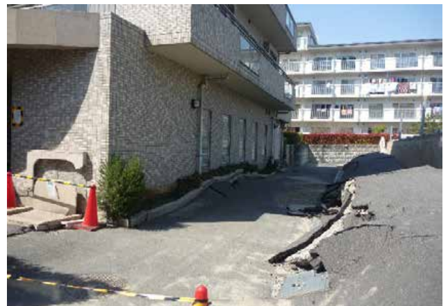
写真6 横浜市内の地下駐車場の浮き上がり(2011年東北地方太平洋沖地震)
