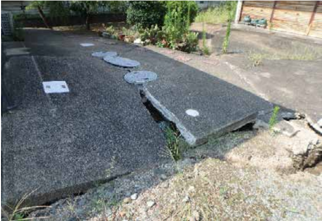
写真1 地下貯水タンクの浮き上がりによるコンクリートスラブの破損(2016年熊本地震)
