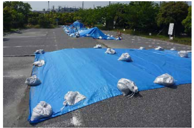
写真4 浦安市内のマンホールの浮き上がり(2011年東北地方太平洋沖地震)
