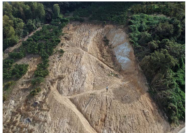
図 7 調査を行った御池の崩壊
