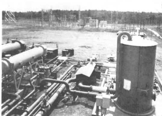
写真—3 油タンクおよび冷却設備
