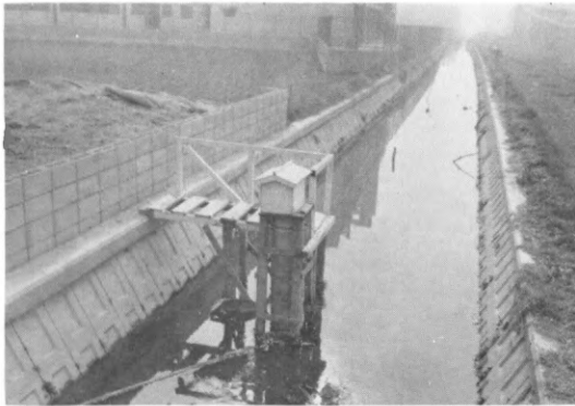
写真-3 内水位測定用の自記水位計設置状況
