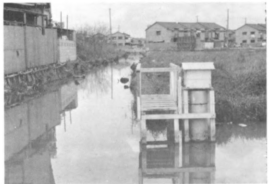
写真-4 内水位測定用の自記水位計設置状況
